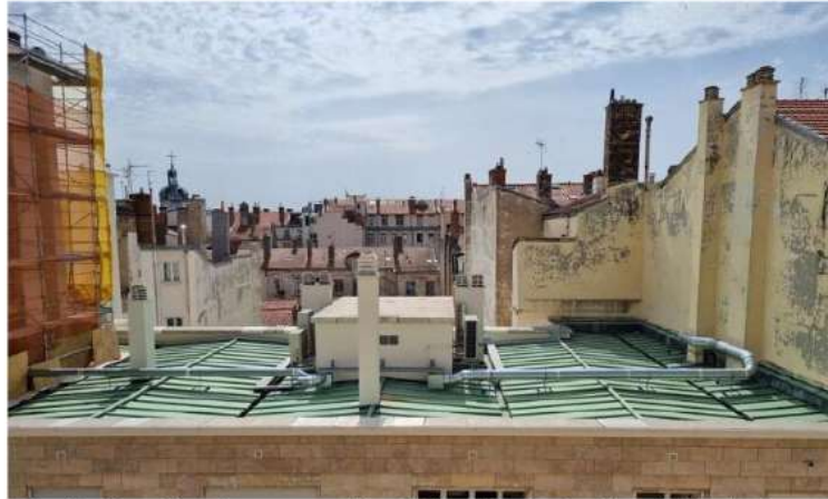
Malgré les démarches et les promesses faites de démolition, les deux blocs de climatisation et les énormes gaines techniques sont toujours là, face au 6 e étage du 6 rue Victor-Hugo.
