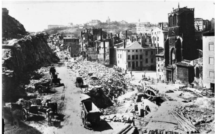
Construction d'une plate-forme destinée à accueillir les voies de la ligne Lyon-Montbrison. Tout à côté sera érigée la gare Saint-Paul. Prise de vue en 1873. Photo Coll. BM de Lyon
