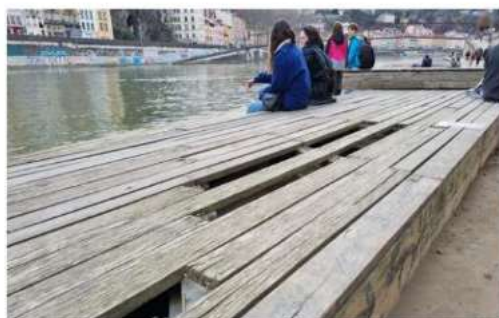
Les affichettes qui interdisent l'accès n'empêchent pas les promeneurs d'utiliser l'ouvrage, au risque de se fouler la cheville ou le pied sur les planches trouées.
