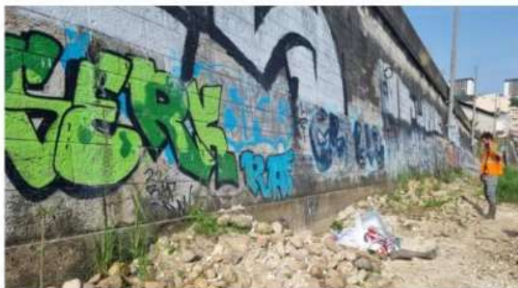
Tags sur les murs du quai Pierre-Scize : « Le phénomène est croissant dans toutes les métropoles. »
