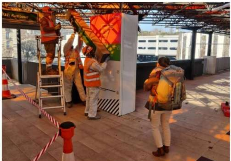
Certains voyageurs, surpris par la fermeture de la passerelle, demandent leur chemin aux ouvriers. Photo Rémi Liogier
