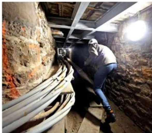
Le réseau qui alimente Lyon en électricité est enfoui à 3 mètres de profondeur en plein centre-ville. Photo R. Mouillaud
