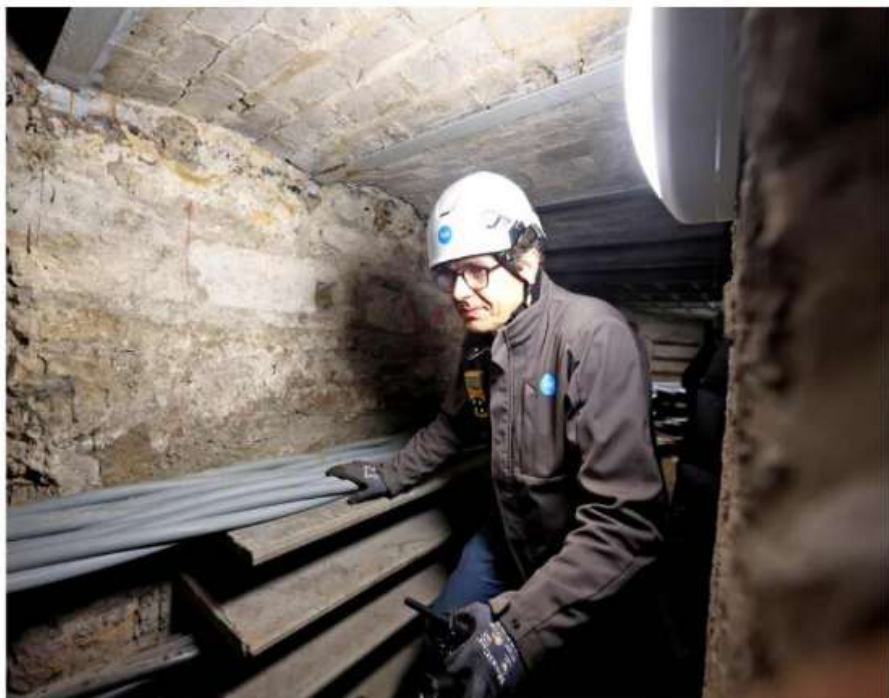
Cédric Auxenfans, directeur de la maintenance RTE, sillonne une des 18 galeries souterraines que compte la Métropole de Lyon. Attention à la tête! Photo Richard Mouillaud
