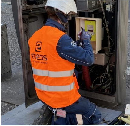
Le technicien Enedis change un disjoncteur.
